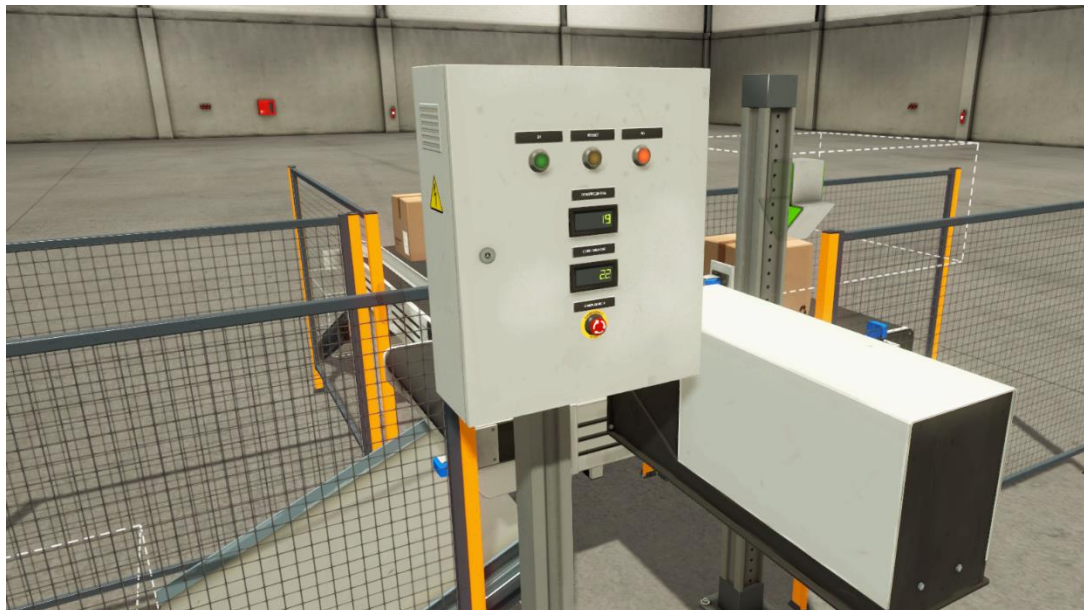
Figura 10 - Disposição dos componentes no painel de comando
