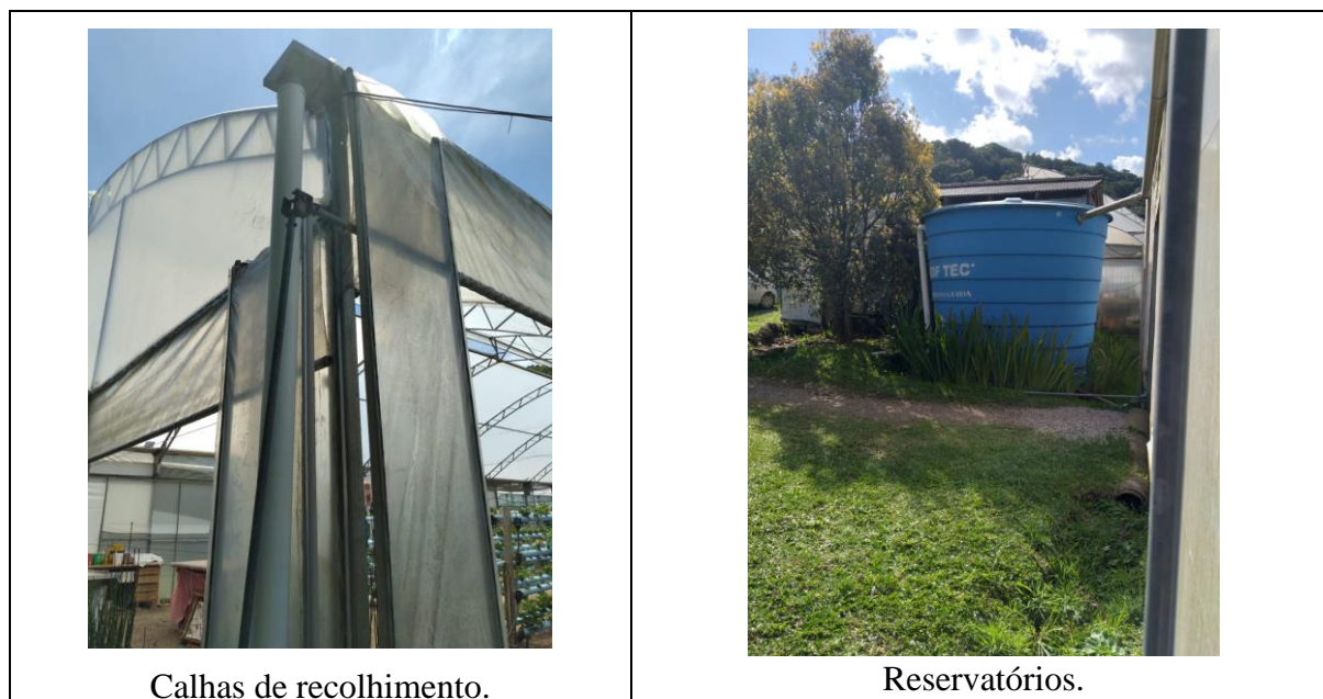
Figura 04 – Sistema de recolhimento de água.
