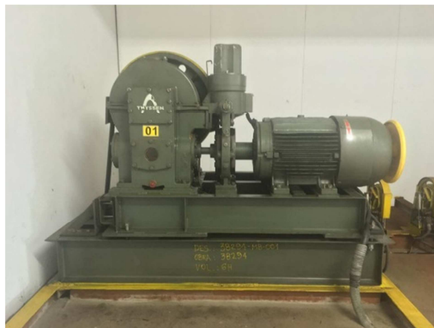
Figura 3 - Máquina de Tração de um elevador Thyssenkrupp
