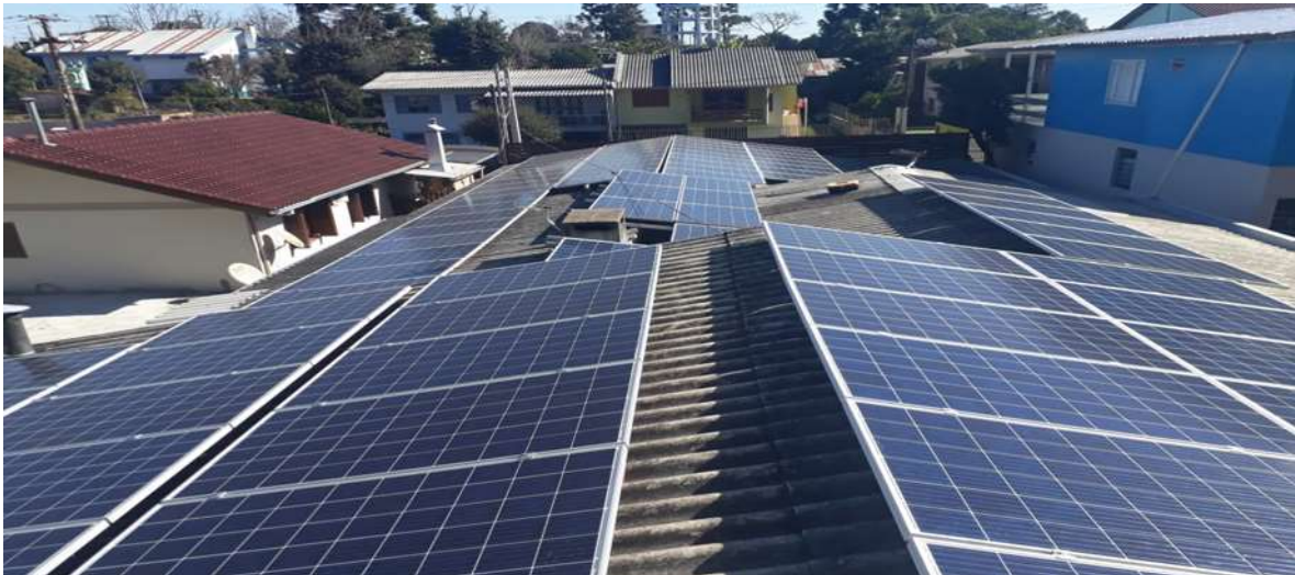
Figura 7: Painéis Fotovoltaicos instalados em uma propriedade de Erechim/RS.
