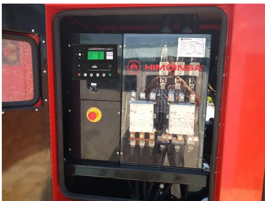
Figura 26 - Foto Gerador e o Controlador DeepSea 8620.
