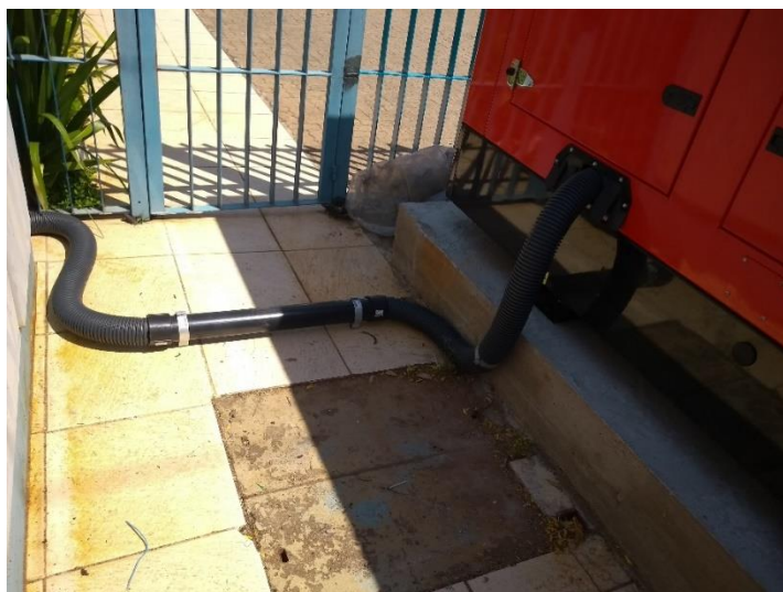
Figura 28 - Conexão da carga ao quadro de transferência automática.
