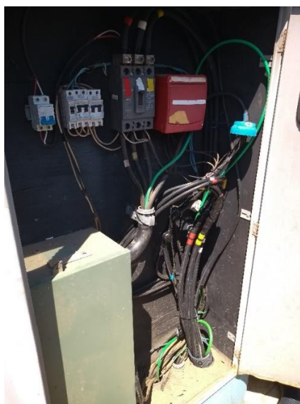
Figura 27 – Quadro de Carga Instalada em atendimento pela concessionária.
