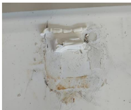
Figura 12 – Backsheet do módulo A após a remoção da caixa de junção
