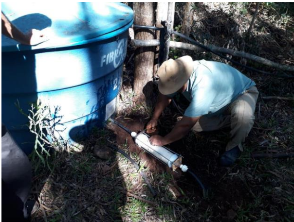
Água da cisternas bombeada para caixa de água e distribuição já existente.
