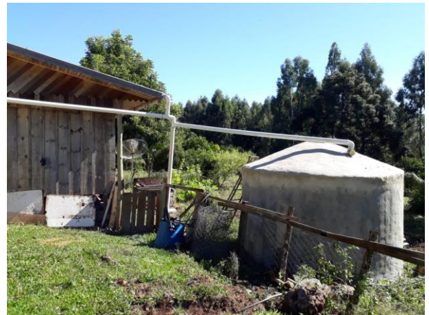
Vista geral da Cisterna e Sistema de captação.
