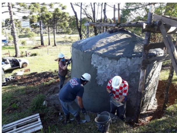
Concretagem da segunda camada da parede e chapéu (de preferência deve ser no mesmo dia para evitar emendas).
