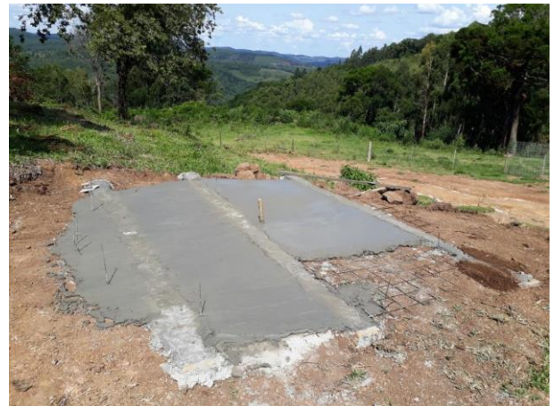
Piso sendo concretado (detalhe para as esperas junto a circunferência, malha de ferro e o cano no centro).
