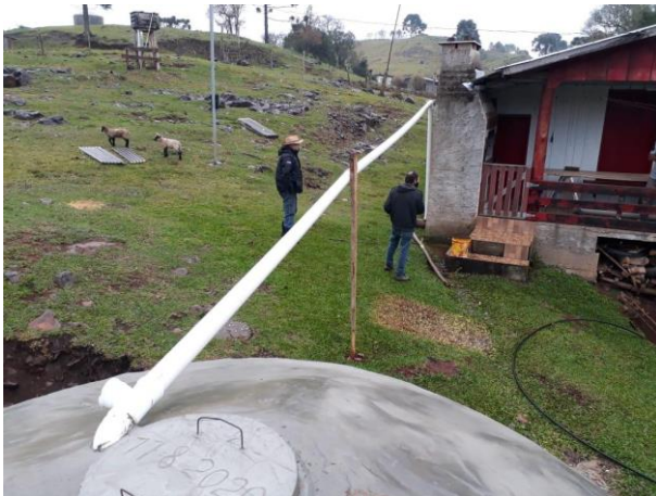
Sistema de captação instalado.
