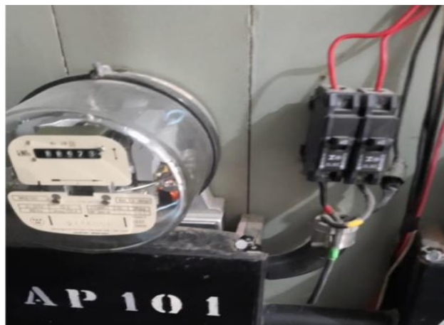
Figura 1 – Medidor de energia elétrica do apartamento.
