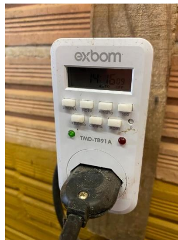
Imagem 4- Timer digital de acionamento da motobomba
