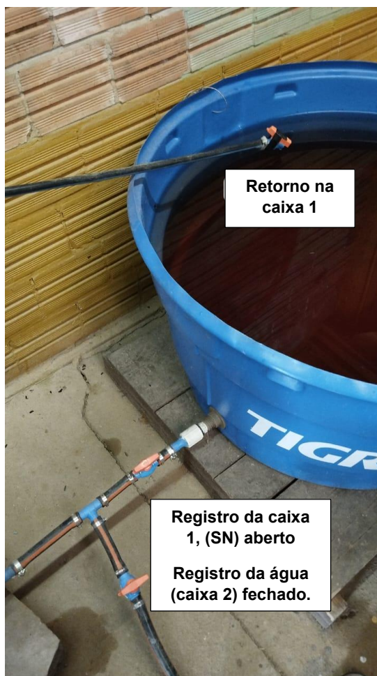
Imagem 6- Retorno dentro da caixa que está com o registro aberto
