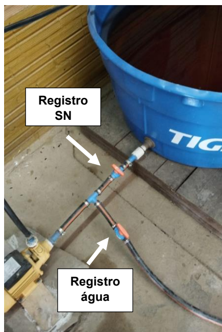
Imagem 5- Registros das caixas do sistema hidráulico interno.
