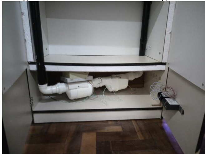
Figura 6.9 - Sistemas de controle no gabinete
