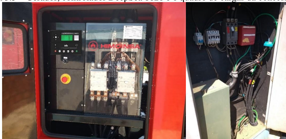
Figura 3.5 – Gerador, controlador DeepSea 8620 e o quadro de cargas da concessionária
