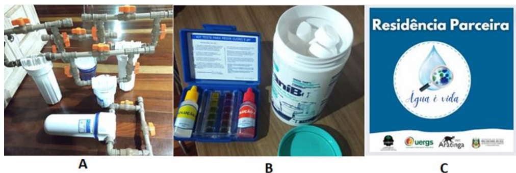
Figura 1. Sistema de tratamento instalado na comunidade Aratinga composto por: sistema de cloração (A); cloradores instalados nos locais; (B) kit colorimétrico + pastilhas de cloro (B); placa de identificação fixada nas residências (C).
