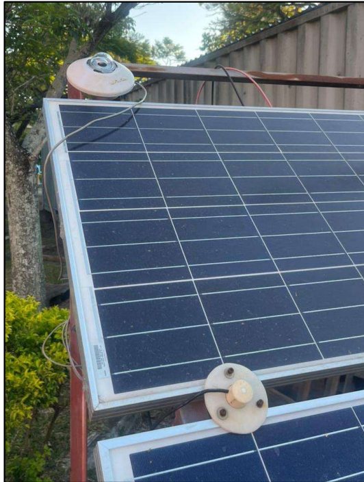
Figura 19 – Piranômetros de referência e fotovoltaico instalados em campo
